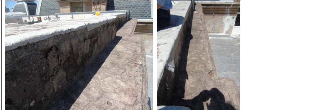
Estado de los revocos en muro de carga y sobre cornisas
