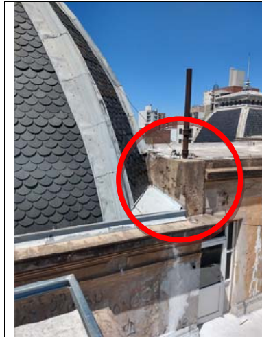
Revoques a demoler parcialmente y reconstruir, zona azoteas, muro de carga lateral oeste a cúpula central
