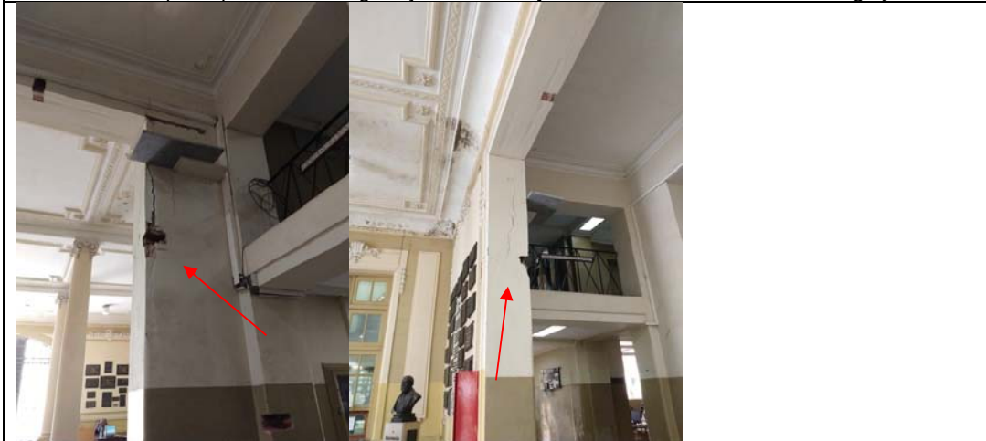
Zona dañada a retirar revocos y reponer – Planta Baja - Hall
