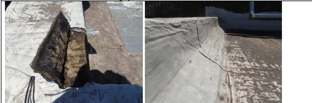
Estado del revoque superior de la carga bajo membrana y detalle del encuentro entre la carga y la azotea
