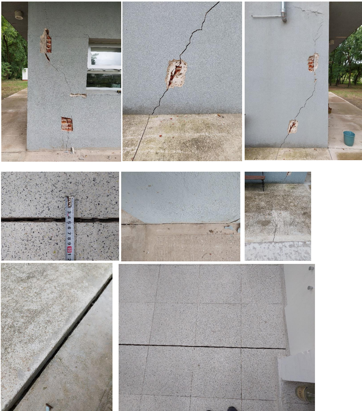
Patologías en pisos, contrapisos , Mamposterías y Revoques
