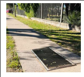
RP3_rejas desagüe vereda.
